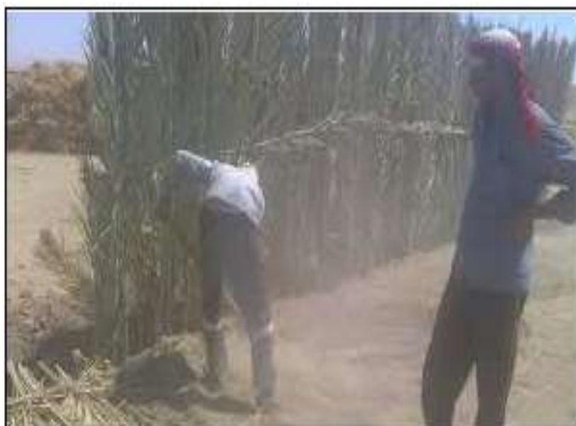
صورة (٢): قيام أهالي قرية المنيرة بالخارجة بعمل مصدات رياح باستخدام سعف النخيل. (المصدر: الدراسة الميدانية، واتجاه النظر نحو الشرق)
